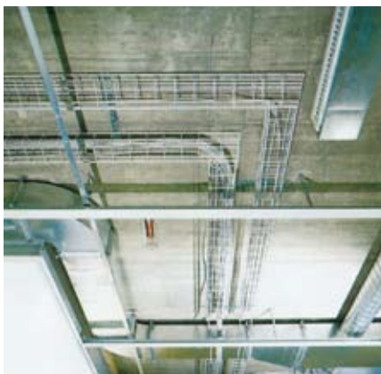
G-Kanäle Platz sparend direkt unter Decke montiert.
